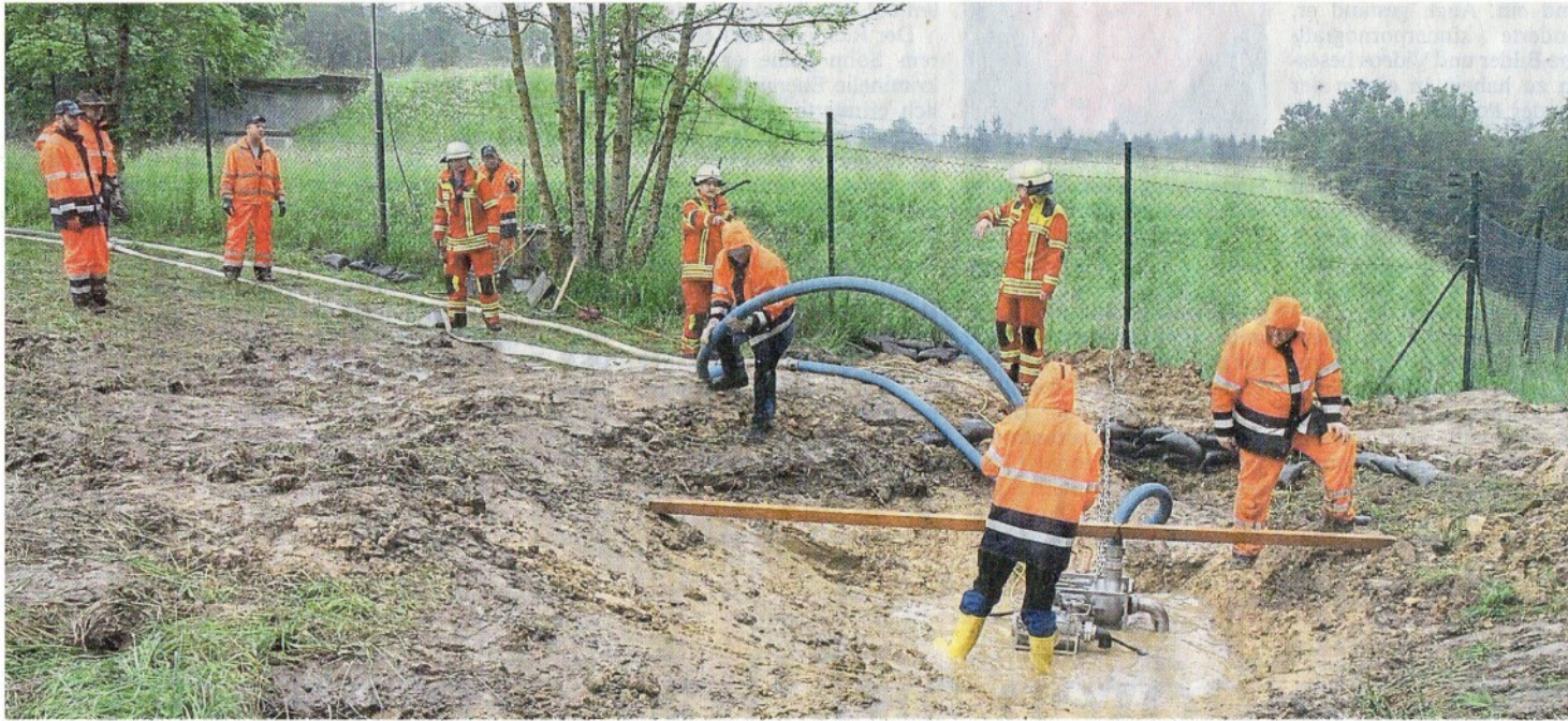
Land unter: Im Juni 2016 ließ die Stadt nach stundenlangem Dauerregen oberhalb des Bergwalds zunächst provisorisch eine Grube ausheben und das Wasser abpumpen – und schließlich ein Rückhaltebecken anlegen.
